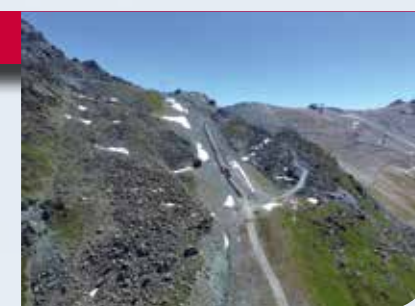
Der Kabelgraben verläuft größtenteils entlang der Seilbahntrasse bzw. im Bereich des bereits bestehenden Grabens.
